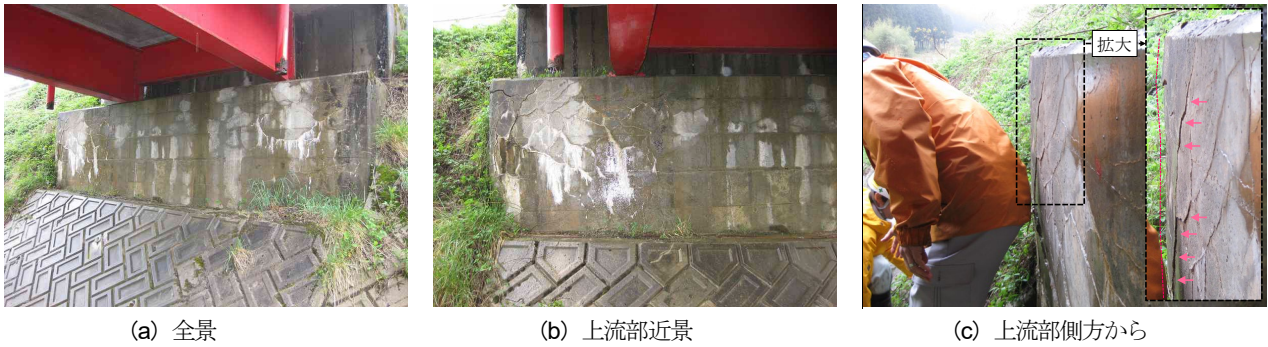
図-1 変状確認時のA1橋台
