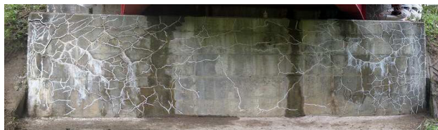
図-1 A1 橋台 (左岸) のひび割れ発生状況 (マーキング後)
